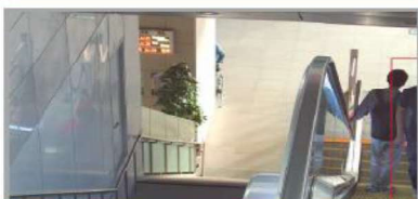
電梯逆向警報: 第一月台北側
